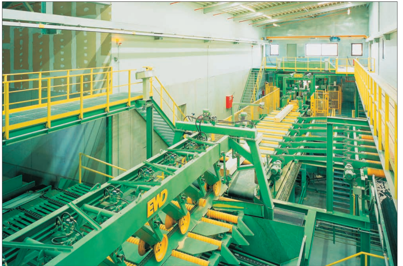
Die Sägehalle am Standort Morbach wurde so konstruiert, dass es möglichst wenig Stellen mit Anhäufung von Staub gibt, die sich im Brandfalle entzünden könnten. Dabei konnte auf die Installation von Absauganlagen verzichtet werden.
