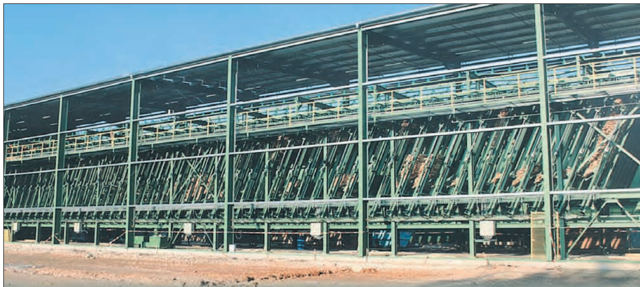
Das Sortierwerk mit 50 hydraulisch absenkbar Schrägboxen – hier eine Aufnahme aus der Inbetriebnahmephase, bei der noch die Seitenverkleidung der Anlage fehlt. Foto: Kallfass
